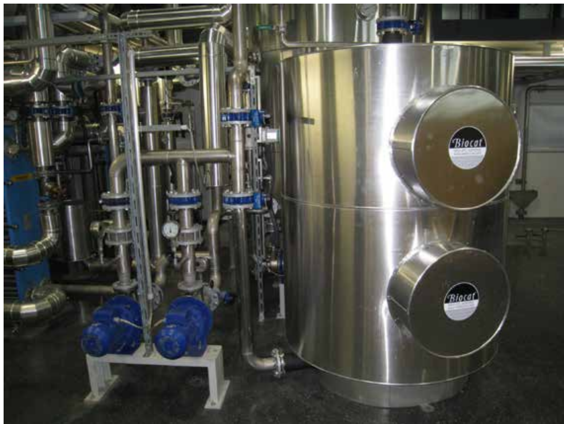
Figur 14: BIOCAT HY 30-specialanlæg i opladningskredsløbet i en 13 m 3 varmtvandsbeholder.
