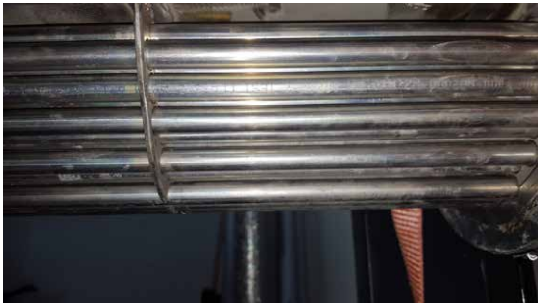
Figur 19: Rørbundtet i understation 33/100, der drives med vand fra BIOCAT-kalkbeskyttelses anlægget KS 5D, havde ingen kalkaflejringer efter 18 måneders drift og et vandforbrug på 648 m 3 .
