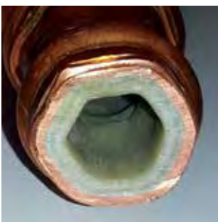
Kobberrør med et kalklag
