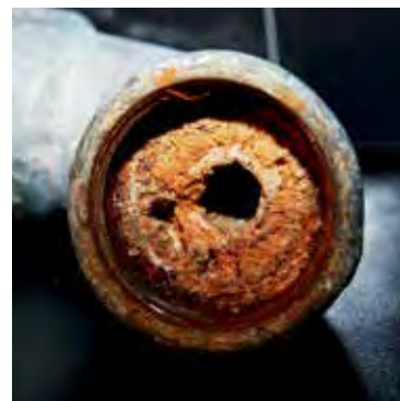
Kalkaflejring i drikkevandsrør
