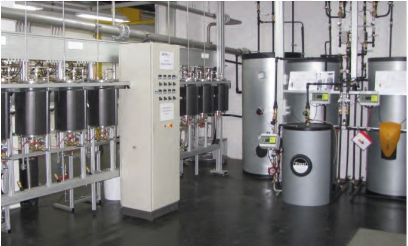
Testfacilitet i henhold til DVGW W 512 til test og egenkontrol af kalkbeskyttelseseffektivitet for koldt- og varmtvandsapparater i henhold til DVGW W 510 som en del af DVGW-typeafprøvningscertifikaterne i det tekniske testcenter hos WATERCRYST i Kematen.
